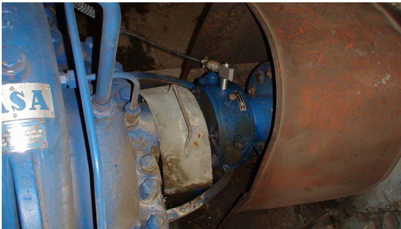
Příklad špatného konstrukčního řešení, možnost měřit pouze pod úhlem 45°.
