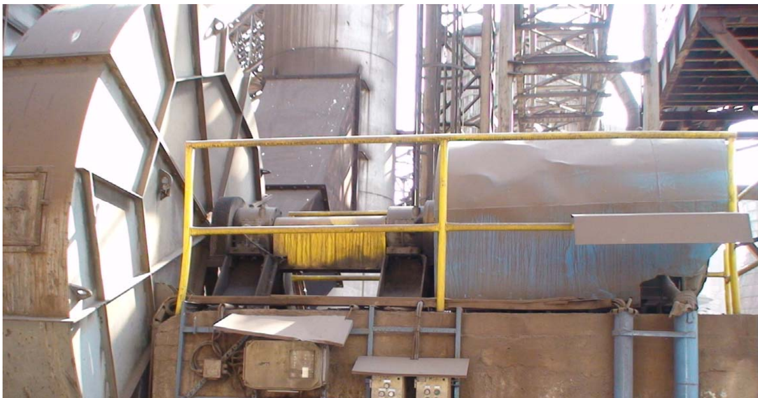
Problematický přístup - zakrytován celý motor.
