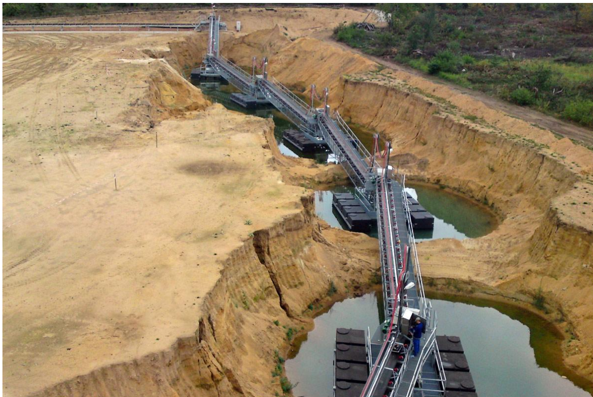
Obrázek 1 - Plovoucí systém, který je součástí většího projektu výsypu / překládky materiálu přes vodu. Dopravník je umístěn nad hladinou, pravděpodobně s částí otočného mechanismu [5].
