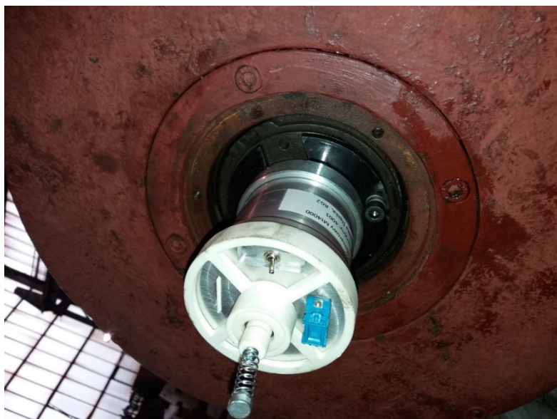
Rys.6 Momentomierz zabudowany w silniku napędowym kruszarki ścianowej KS4 w trakcie testów w hali montażowej (źródło: opracowanie własne)
