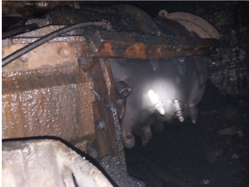
Rys.8 Ścianowa kruszarka KS4 w wyrobisku ścianowym [źródło: oprac. własne]
