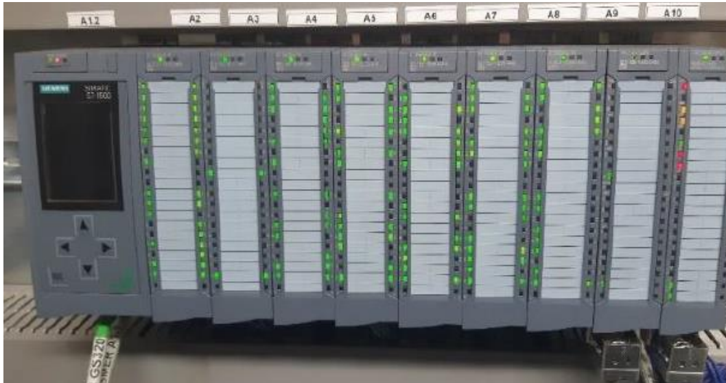
Obr.12 Průmyslový počítač Siemens SIMATIC S7-1500
