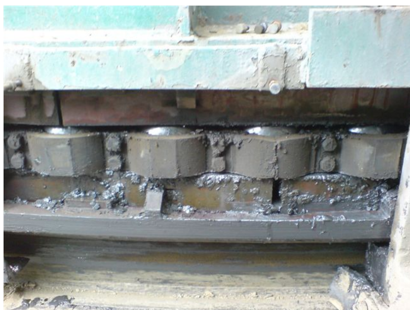
Obrázek 12 - Detail kulové dráhy původní mazivo, výrazný kovový otěr
