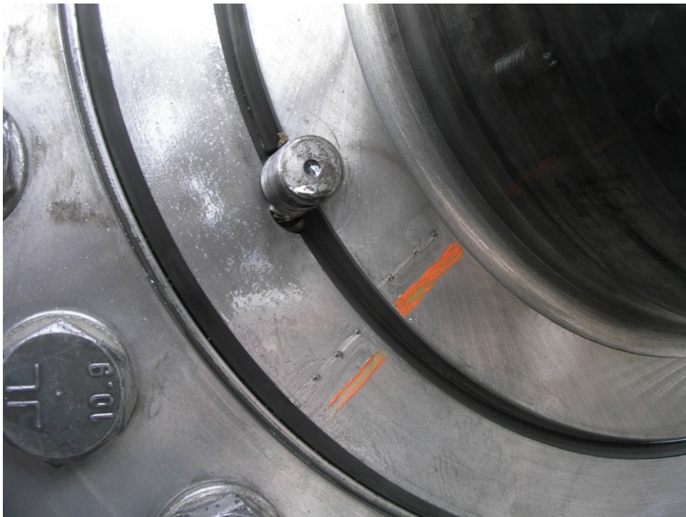
Obr. 27 – Porucha svěrného spojení
