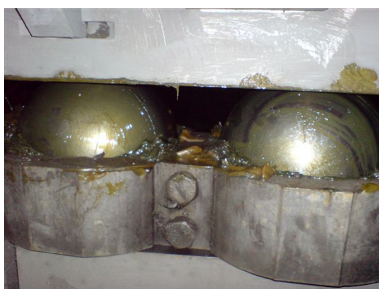
Obrázek 11 - Stav po dlouhodobém provozu
